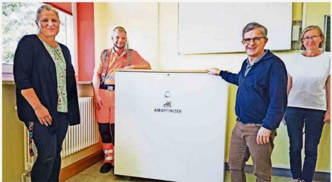
Wie eine Kommode steht der Luftfilter in der Ecke des Klassenzimmers. Der grüne Punkt in der Mitte ist die CO 2 -Ampel. Unser Bild zeigt (von links) Pamela Michel, Leiterin der offenen Ganztagschule, Hausmeister Benjamin Quaiser, Bürgermeister Karl Philipp Ehrler und Schulleiterin Sabine Wohlrab. Foto: cs
